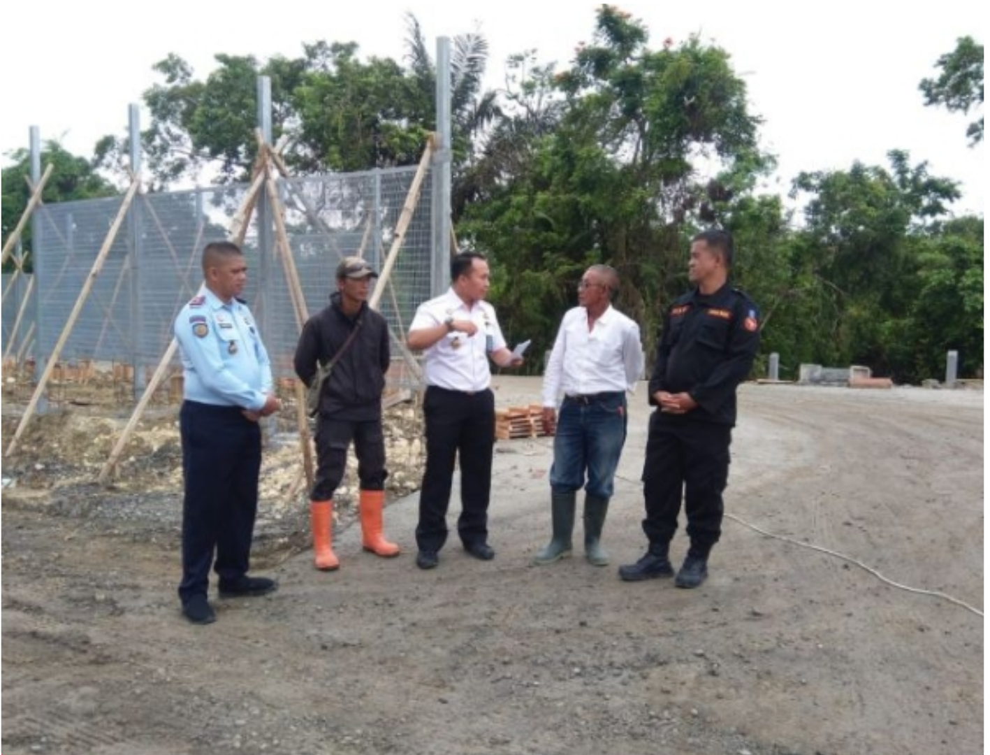
Plt. Kalapas Karanganyar Beserta Jajaran Kepala UPT Nusakambangan - Cilacap Tinjau Progres Pembangunan 3 Lapas Baru
